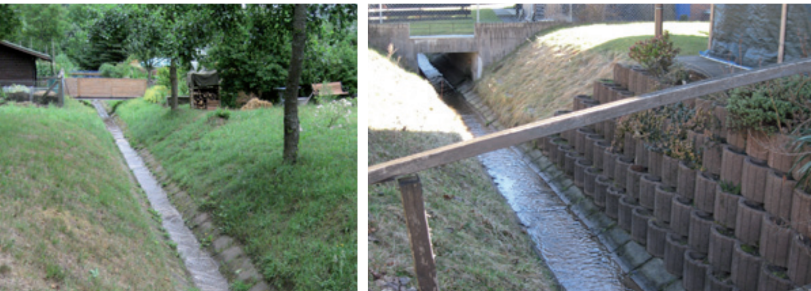
Abb. 15: Übergangshilfe und Einengung des Abflussquerschnitts
